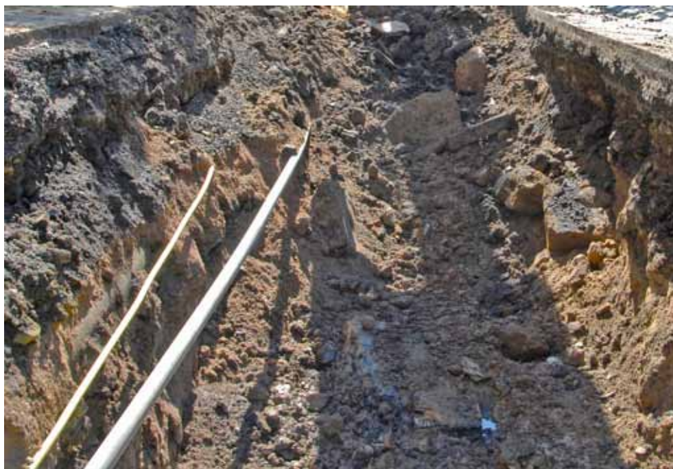
Figur 7. I schaktet vid delsträcka 6 där plankor börjar kika fram i botten och sprängsten kan ses i fyllningsmassorna. Notera rören och ledningarna som går i schakt och i sektionen. Hela delsträcka 6 var störd av sentida schaktdragningar. Foto: Karl-Fredrik Lindberg.
