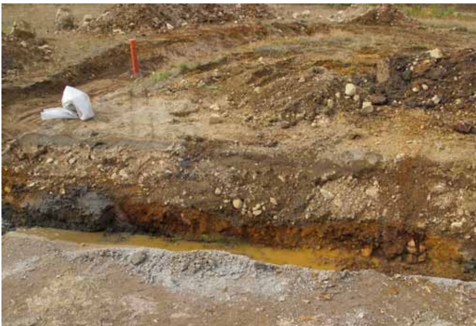
Figur 7. I schaktet syntes rostrester och därunder gröna kopparutfällningar, A2, längst bort spår av ytterligare en rost, A1. Foto: Eva Carlsson
