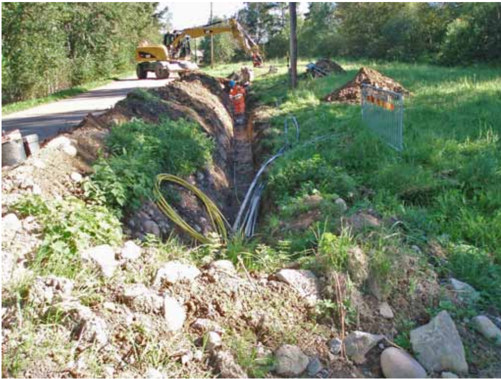
Figur 6. Schaktet vid RAÄ 46 håller på att grävas. Fotot taget från SV. Fotograf: Greger Bennström.
