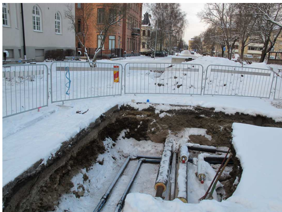
Bilaga 3. Den centrala delen av schaktet i Bergmästargatan. Foto från sydöst. Fotograf Joakim Wehlin.
