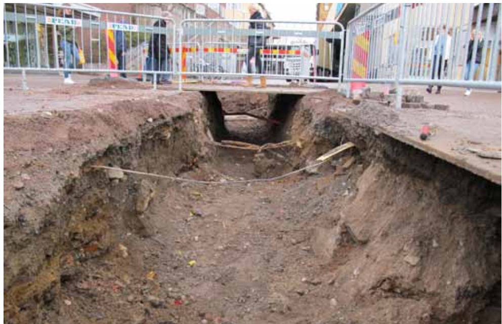
Figur 4. Schaktet vid Bergsskolegränd med startgropen i bakgrunden. Fotograferat mot nordöst. Fotograf Britt-Marie Hägerman.
