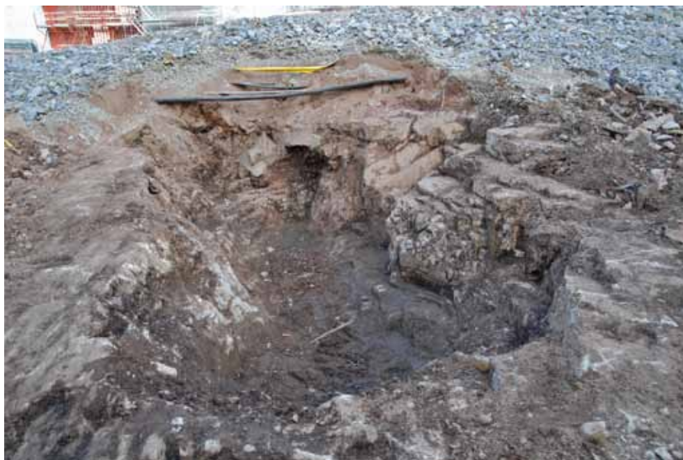
Figur 8. Skärpningen efter rensning fotograferat mot nordost. I övre delen av bilden syns högspänningskabeln och bergkross från vägbanken. Fotograf: Eva Carlsson.
