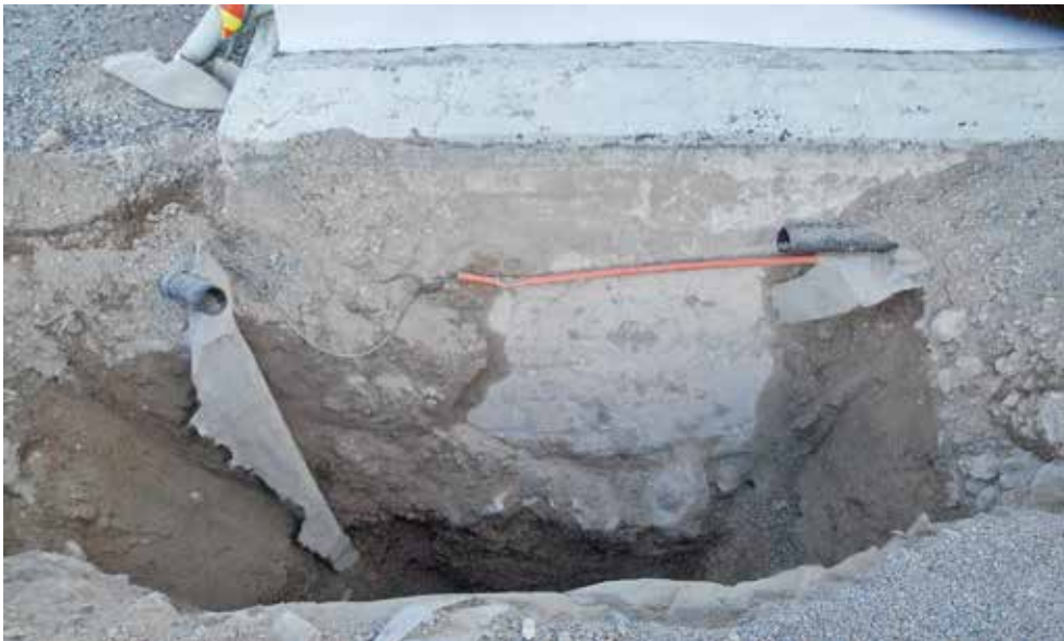
Figur 7. Översiktsbild över schakt 2 med stödmuren längst ned i bild. Fotograf Jimmy A Karlqvist
