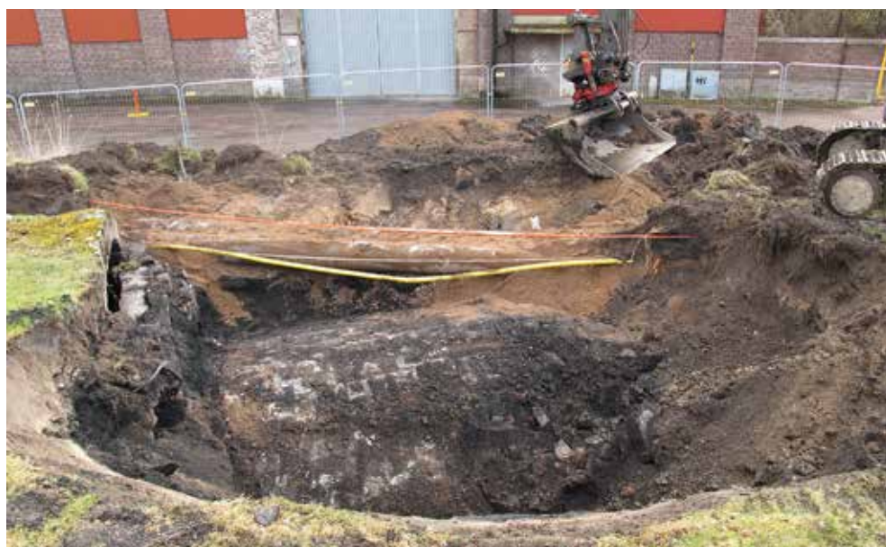
Figur 6. Kulverten med kallvalsverket i bakgrunden. Foto från norr. Fotograf Jimmy A Karlqvist.
