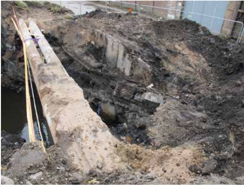
Figur 9. I södra delen av schaktet, mellan fjärrvärmeledningen och betongfundamentet, fanns en mindre yta som kunde undersökas närmare. Från nordväst, fotograf Jimmy A Karlqvist.
