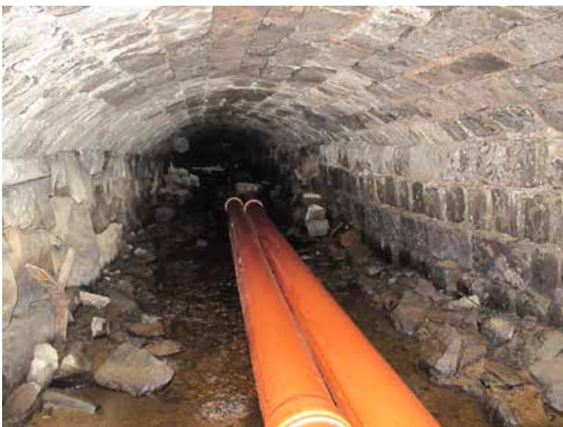
Figur 11. Kanalens nordvästra del. Till höger i bild ser man att kulverten är anlagd ovan berggrunden. Till vänster i bild sticker ankarlutet som har en form av ett X ut ur stödmuren. Från sydost, fotograf Jimmy A Karlqvist.
