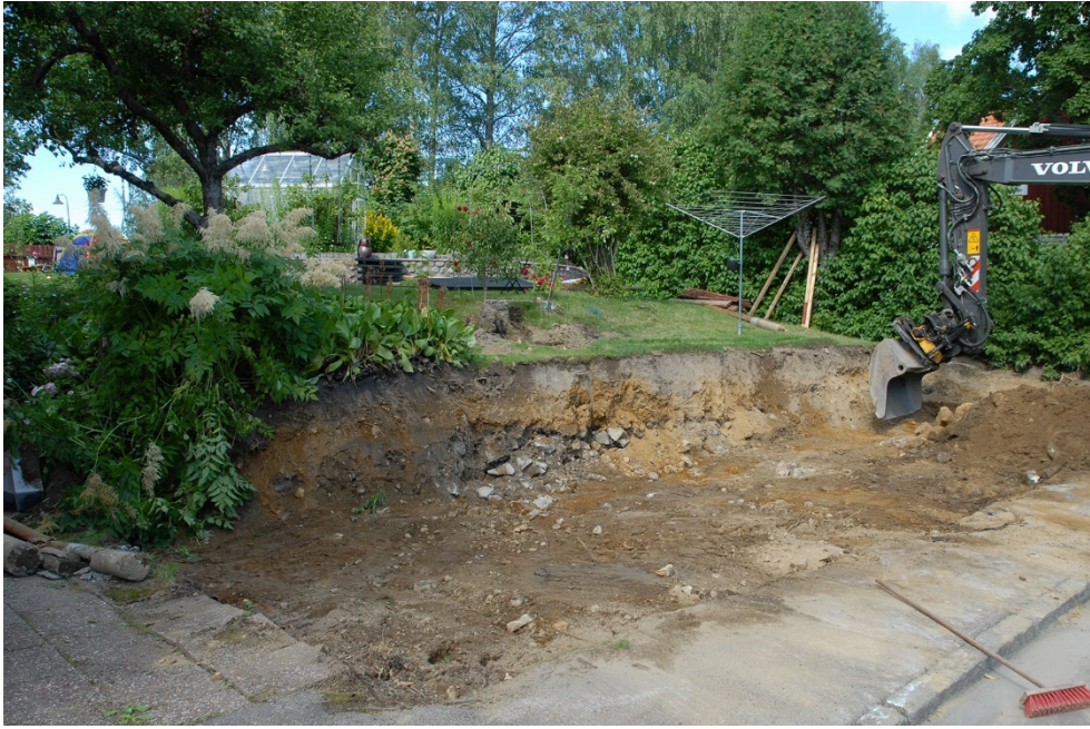
Bilaga 3. Schaktningen är i det närmaste slutförd. Ovanför slänten ans vattenreservoarens stenmur. Foto: Eva Carlsson.
