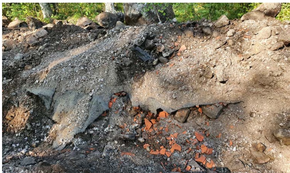
Figur 9. Schakt 9. Del av den nordvästra schaktväggen med utfyllnad av tegel och takpannor under markduk. Det förekom mycket stenblock i område 4. Från sydost. Foto: Emelie Svenman.
