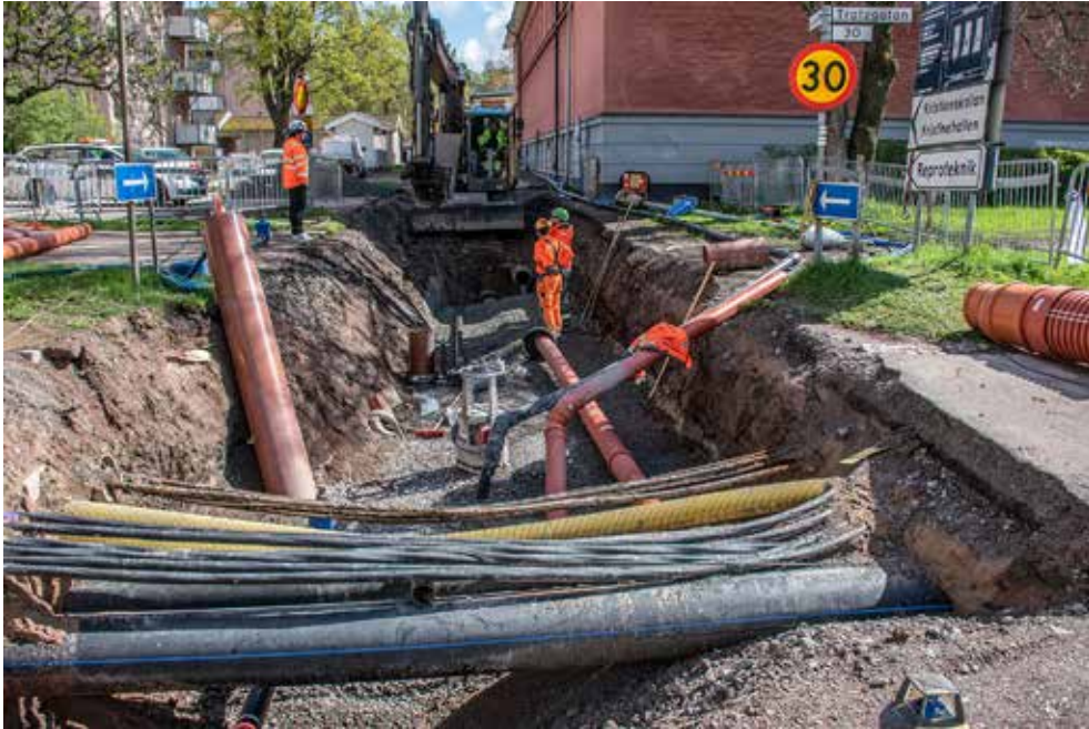
Figur 6. Översikt över östra delen av schakt 1 vid pågående arbete från Trotzgatan. Schaktet togs upp etappvis där schaktet grävdes och sedan lades rören ned och schaktet lades igen innan nästa etapp grävdes. Från sydväst. Foto: Lee Widegren Lundin.
