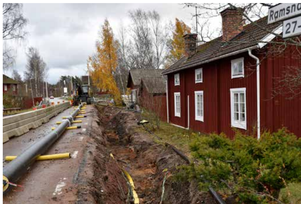
Figur 9. Schakt 2 längs Ramsnäsvägens södra sida. Tidigare nedgrävda ledningar fanns i schaktet, både den vattenledning som skulle ersättas och andra ledningar. Foto från väster, Eva Carlsson.
