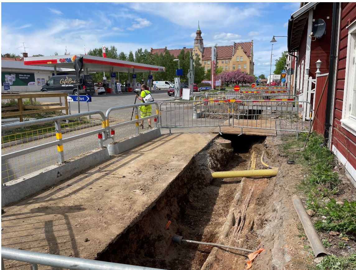
Foto 1: Översikt över schaktets läge längs östra sidan av Hyttgatan. I bakgrunden syns Gruvgatan 19, en bensinmack där laddstationer för elbilar skall installeras. Foto från sydöst. Fotograf: Linda Wigert.
