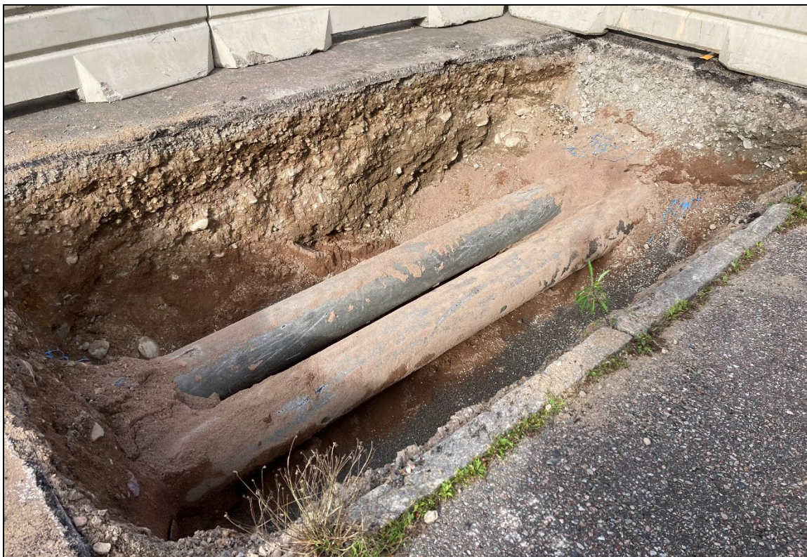
Foto 1. Det djupare schaktpartiet i gatan. Tidigare ledningsschakt. Från sydöst. Foto: Lee Widegren Lundin.
