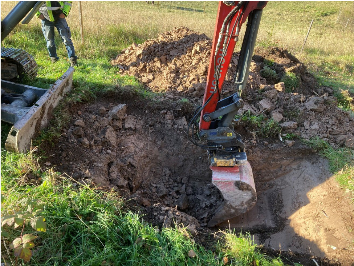
Foto 1: Pågående schaktning av provgrop från öst. Endast ljus rödbrun lera syntes under den tunna matjorden. Foto: Lee Widegren Lundin.
