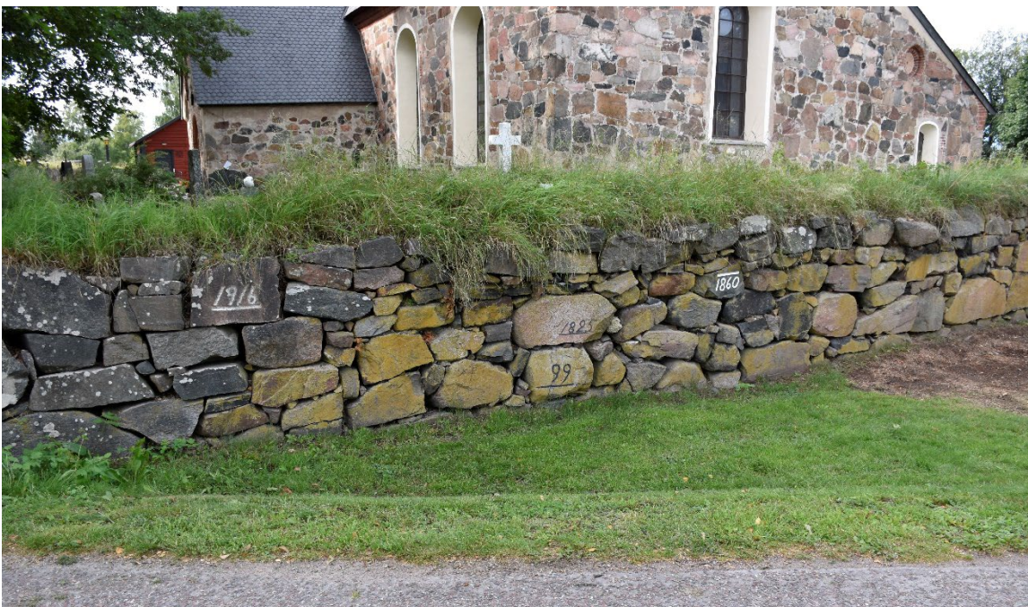
Foto 1. Sektion 1 med vattenståndsmärken innan restaurering. Foto: Greger Bennström.
