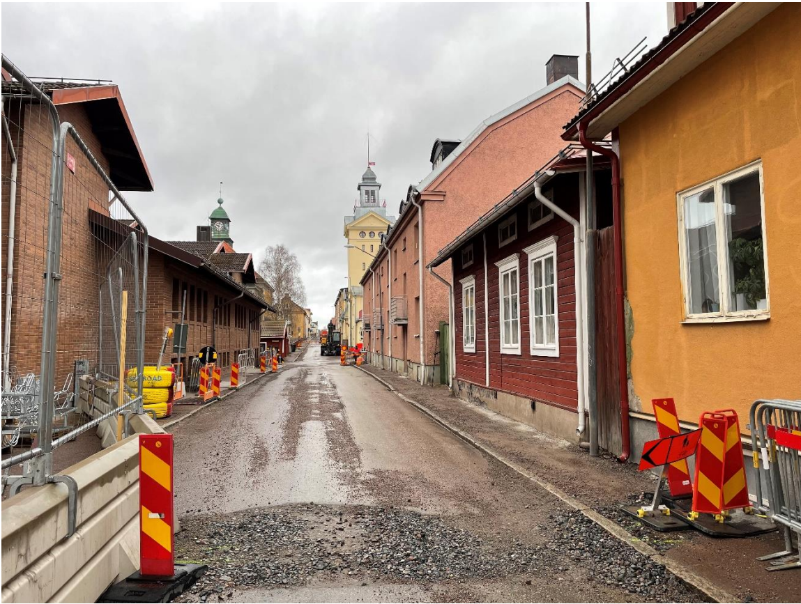
Foto 1: Översikt Sturegatan 72-89. Det igenlagda schaktet löpte längs husväggen till höger i bild. Foto mot sydöst. Fotograf: Linda Wigert.
