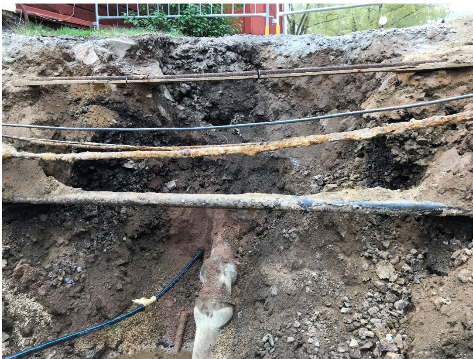
Foto 2. Sydöstra schaktväggen med de homogena slagglagren synliga bakom ledningarna. Foto: Greger Bennström.
