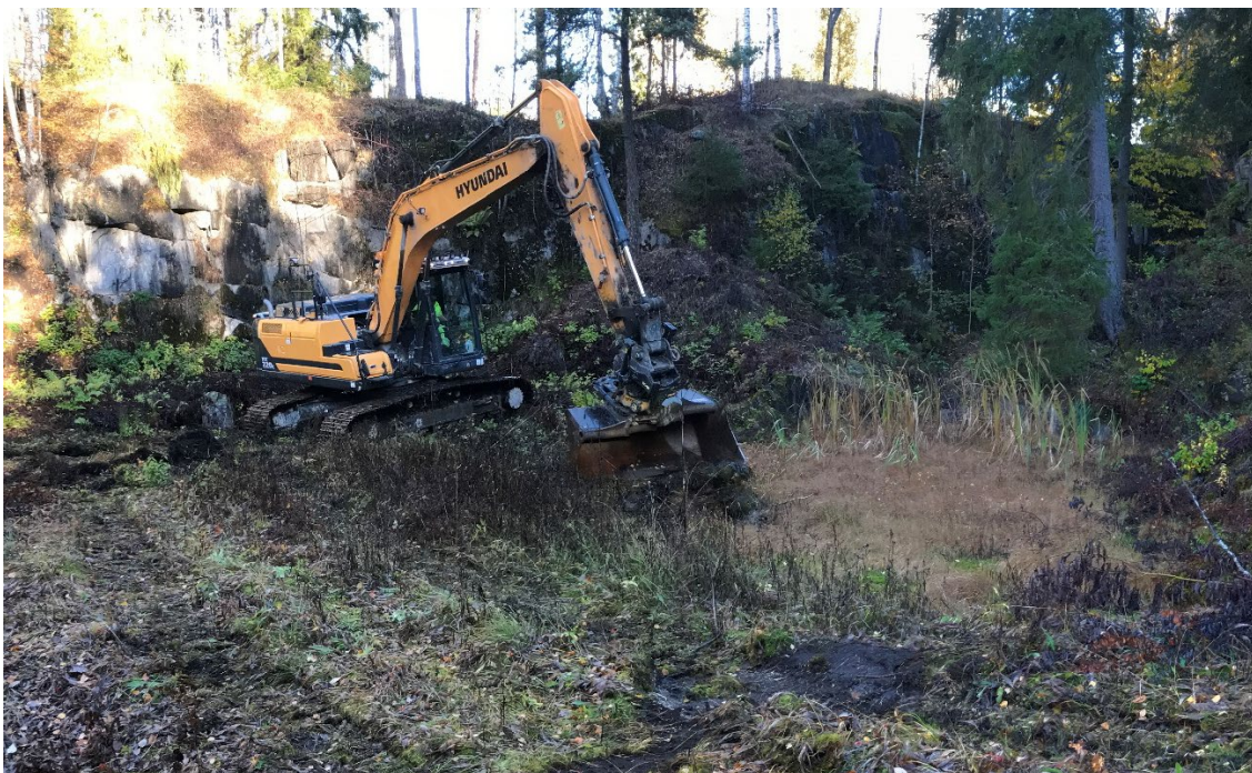
Figur 4. Det nordöstra området med vegetationen innan schaktning. Foto från sydöst, David Fahlberg.
