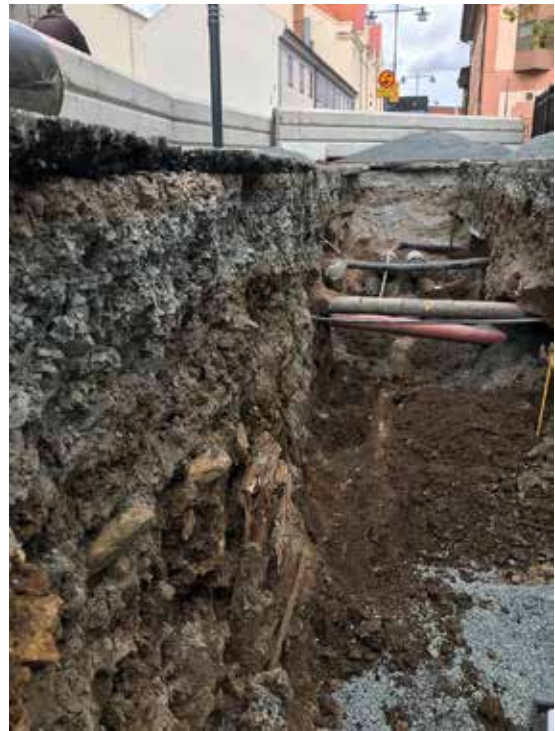
Figur 2. Framkomna lämningar i den NV änden av schaktet i form av en längre timmerstock samt kulturlager. I den västra schaktväggen fanns även uppfläkta rester efter flera stockvarv. Foto från SÖ, David Fahlberg.
