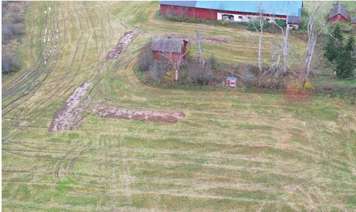
Figur 5. Sökschaktsområde 4 efter igenläggning av schakt. Till vänster syns kanten av våtmarken. Fotat från nordväst. Foto: Jimmy Axelsson Karlqvist.
