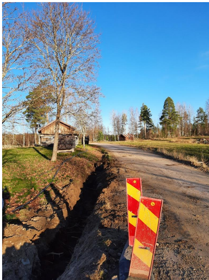
Bilaga 2.5. Översikt, schakt 3. Den registrerade gårdstomten L1999:286 till vänster i bild. Fotat från S. Foto: Emelie Svenman
