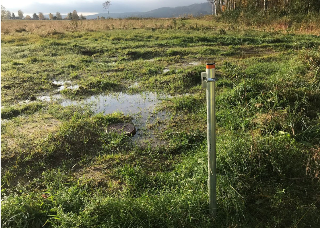
Figur 4. Bortprioriterat område på den sydöstra sidan av Smedjebacksvägen, vattensjukt, med tidigare schakt- och körskador. Omgrävt för kommunalt VA. Foto från N. David Fahlberg.
