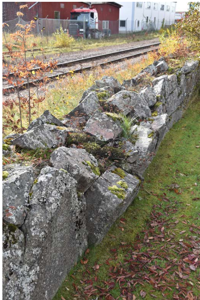
Sektion av den skadade muren på område I-J.
